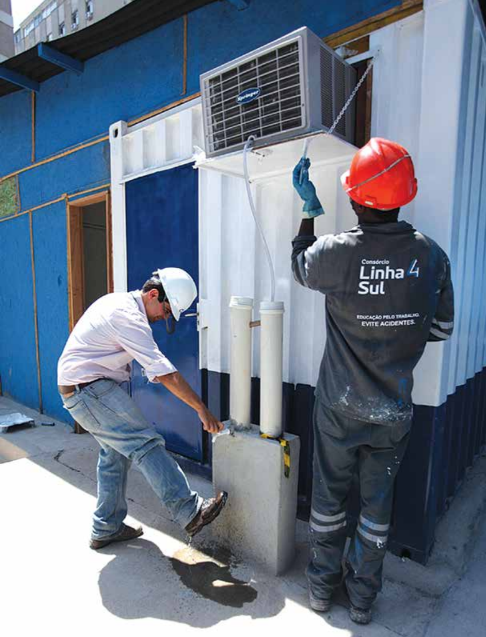
▲ Gotejamento dos aparelhos de ar condicionado também é recolhido para ser reutilizado
