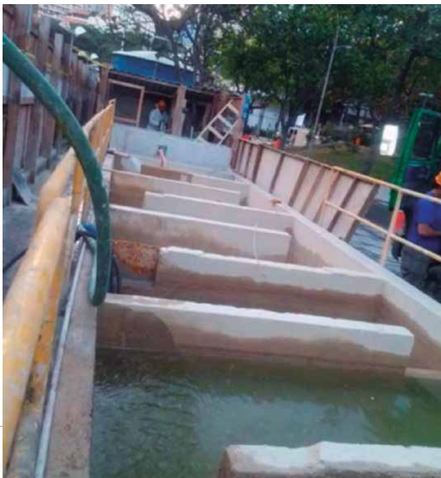
► Estação de tratamento de efluentes industriais no canteiro da central de concreto no Itanhangá
