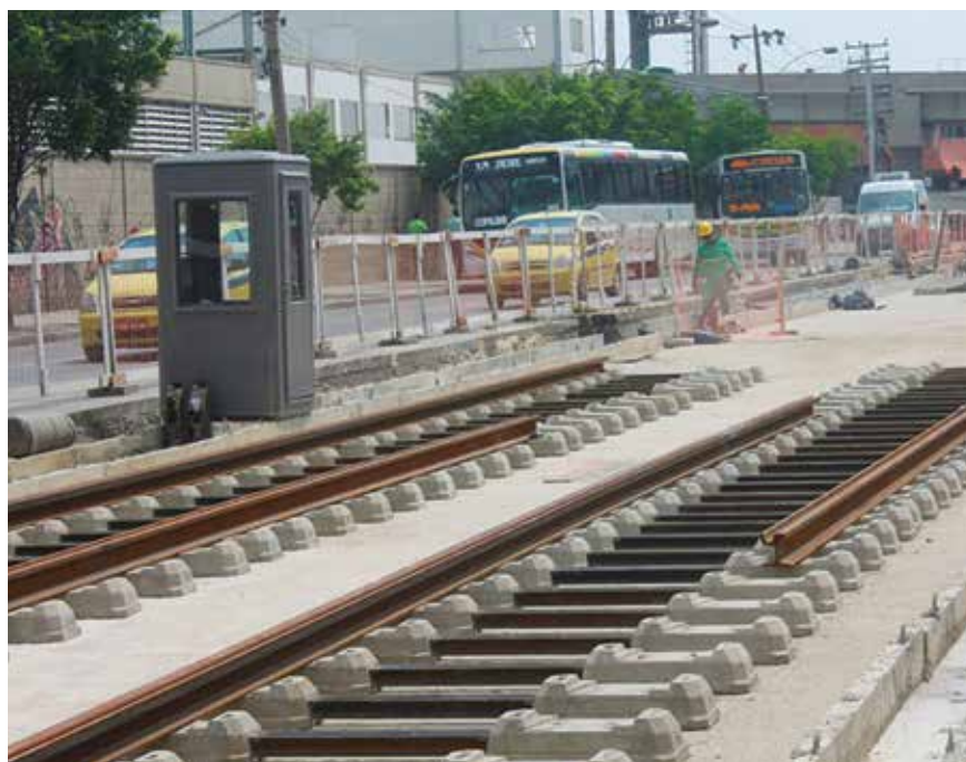
► A alimentação de energia do sistema será através de um terceiro trilho energizado em alguns trechos e nas paradas
