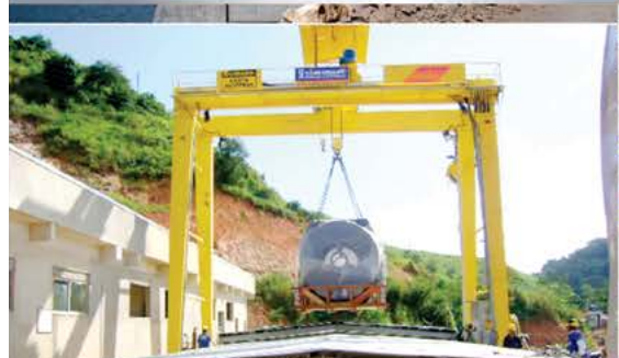
PÓRTICO HIDRELÉTRICA PIPOCA ENERG POWER - IPANEMA/MG
